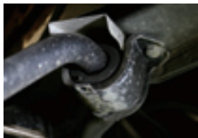
スタビライザーに備わるブッシュ。劣化が進むと開いてきてしまうのがお約束だ。現状ではまだ使えるとのこと。
