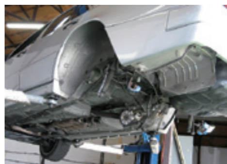
ボディのサビだけでなく足回りを降ろさなくても作業できるが、今回はサブフレームブッシュのボルトにもサビが進行していたため、丸ごと降ろして作業することになった。
