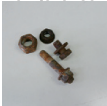
写真のようにサビついたネジは使えない。こうなる前に対処しておくことが必要。サビは早期発見することで修理費用を抑えることができるのだ。
